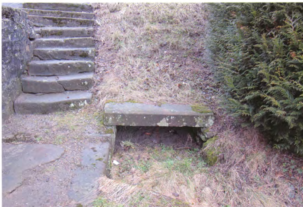
Le débouché du canal d'amenée d'eau (AD)
